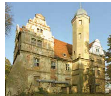
Das Wasserschloss Quilow, noch unsaniert.
