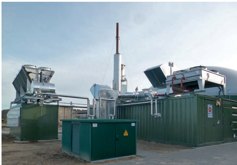
Anlage mit Blockheizkraftwerk und ORC-Anlage.
