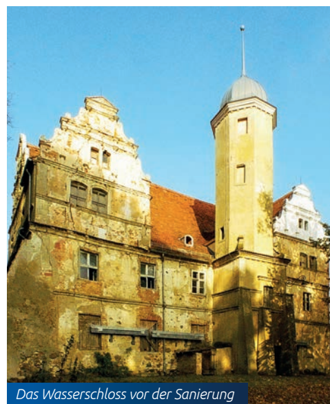
Das Wasserschloss vor der Sanierung
