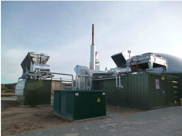
Anlage mit Blockheizkraftwerk (Foto Siggelkower Mooster GmbH)
