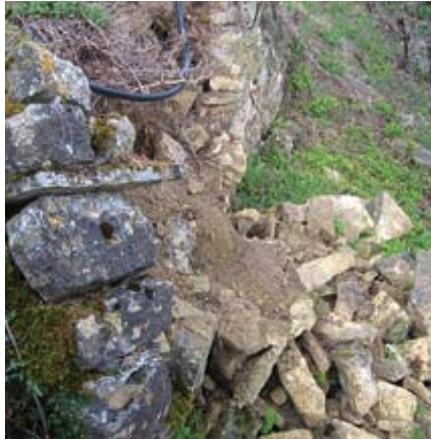
Verfallene Trockenmauer im Ausgangszustand
